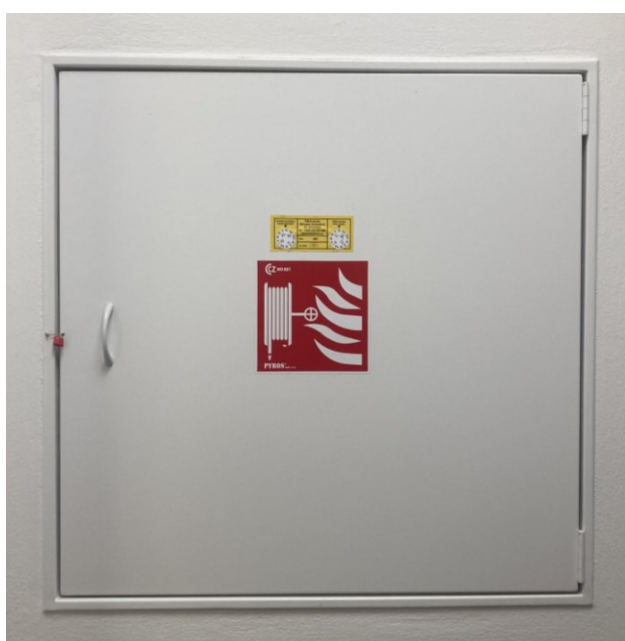
Obrázek 10 Požární hydrant (vlastní fotografie)
