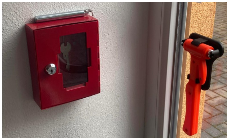
Obrázek 12 Bezpečnostní kladívko a požární klíč (vlastní fotografie)
