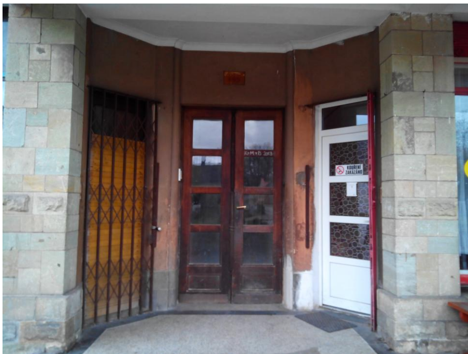
Obr. 30. Stávající stav vstupních dveří
