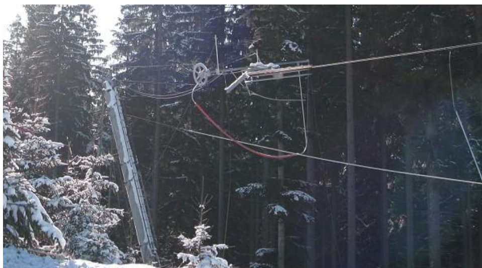
Obr. 11. Sřežení nosného lana vleku, při chodu vleku
