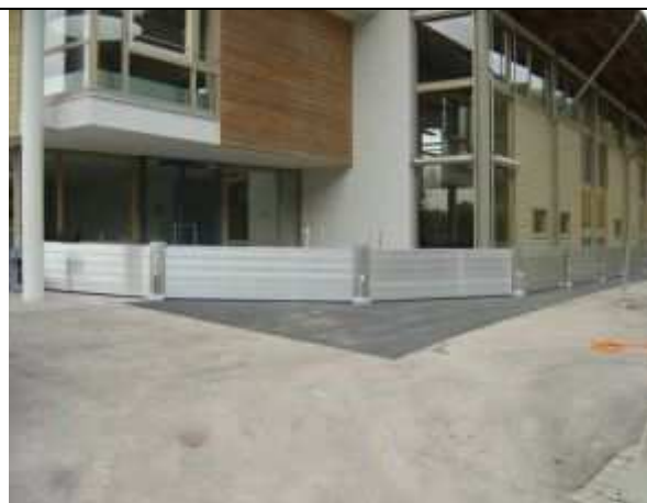
Obrázek 10: Mobilní zábrany pro ochranu celé budovy.
